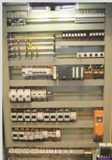
Armoire électrique Stolz
